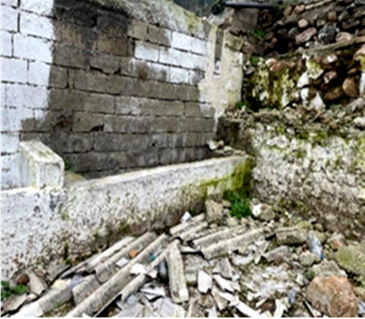
Görsel 5: Deprem Sonrası Harabeye Dönen Su Yapısı
