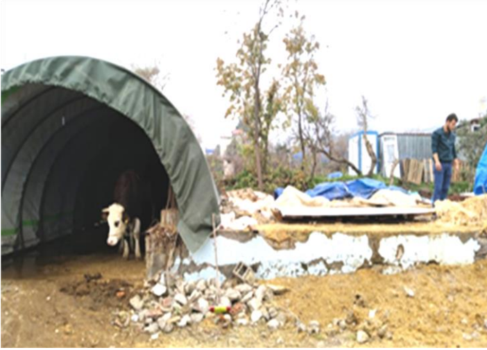
Görsel 2: Yıkım Yaşanan Ahır
